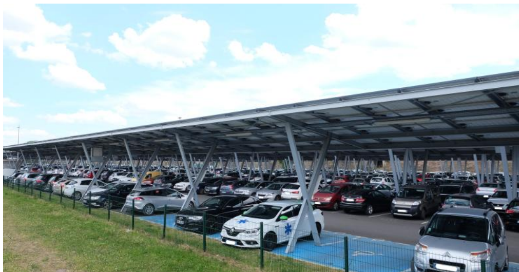
parking ombragé du site Éstaing
